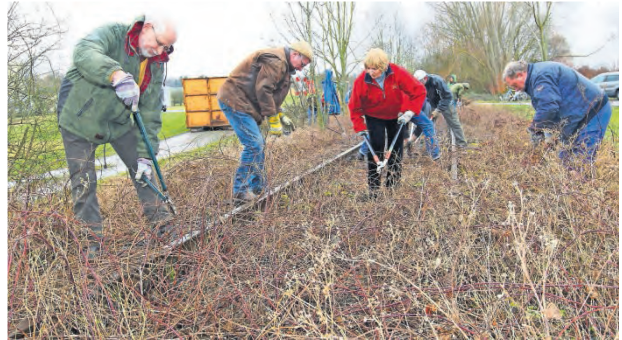
Überwucherte Gleise: Zahlreiche Helfer kamen zur „Schiene frei“-Aktion. Zum zweiten Mal wurde ein Abschnitt bei der Bürgermühle beackert.
