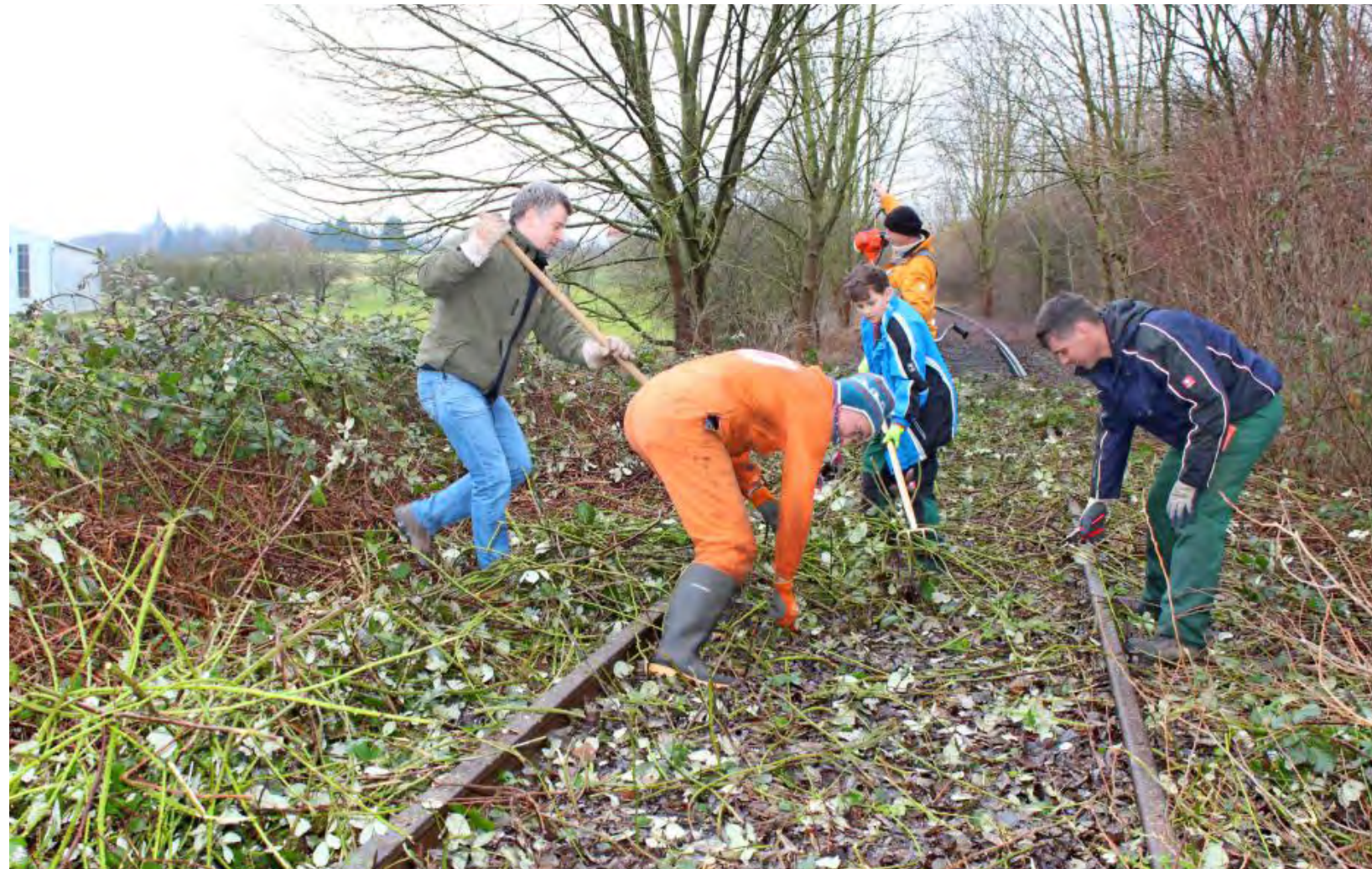
Symbolische Aktion zwischen Brackenheim und Meimsheim: Auf einem Kilometer wurden die überwucherten Gleise der Zabergäubahn freigeschnitten. Foto: Birgit Riecker
